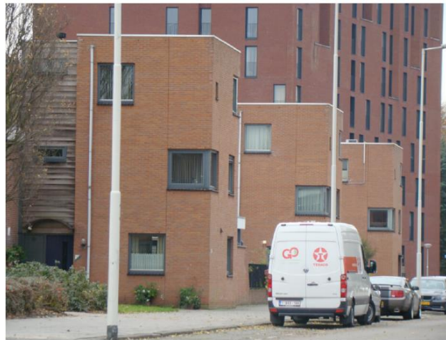
Afbeelding 4: Kraamverblijfplaats gewone dwergvleermuis Max Havelaarweg 142, 176a, 192. In 2013 werden de achterste twee woningen gebruikt, in 2009 de voorste twee. De dieren gebruiken de open stootvoegen op alle windrichtingen onder de dakrand als in- en uitvliegopening. Foto: Ecoresult.
